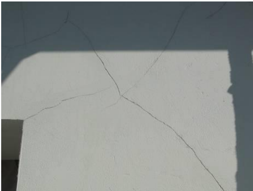
Трещины на поверхности термоизоляционной штукатурки
